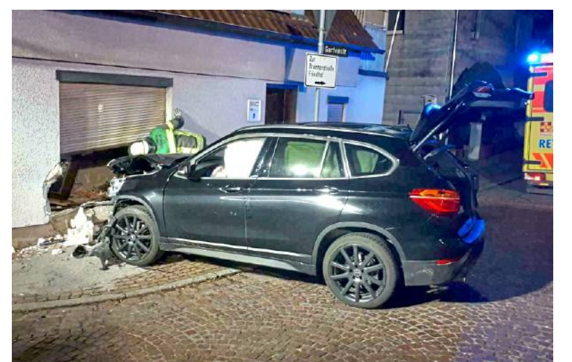
Nach dem Aufprall des BMW ist das Haus an der Ecke Haupt-/Gartenstraße in Gerlingen zunächst nicht bewohnbar. Foto: KS-Images.de/Karsten Schmalz
